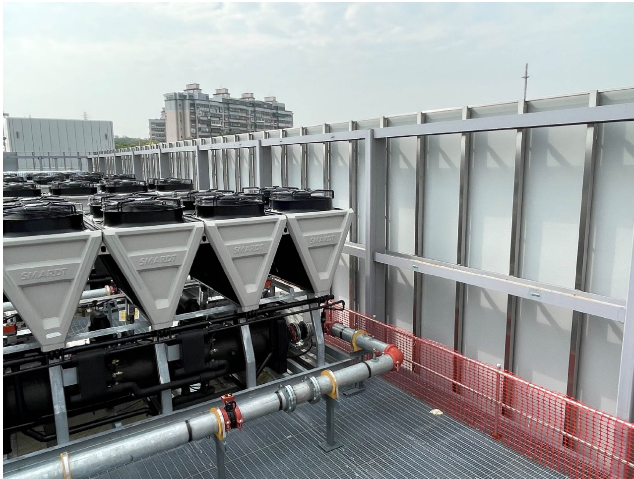
美商廠房水塔吸音牆
